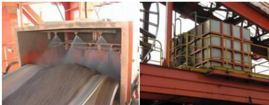
装卸机械上的喷淋系统斗轮取堆料机上的喷淋水箱
